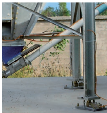
Pesaje de silo
